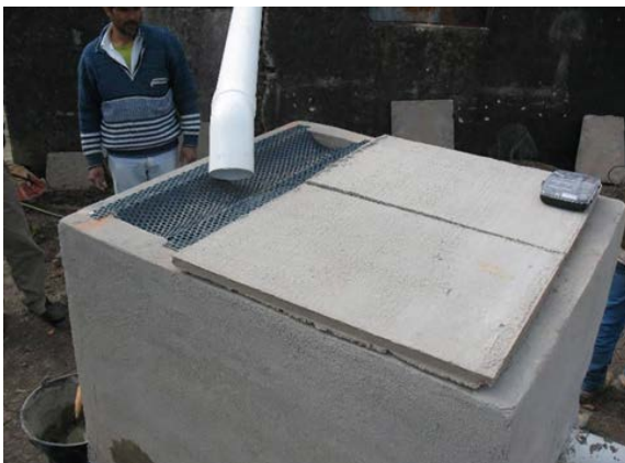
Figura 10. Filtro completo con tapas de protección para el filtro de arena
