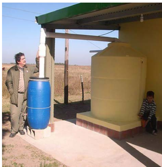
Figura 4. Sistema de trampa inicial de tanque para almacenar el agua sucia para el riego de huerta o forestales
