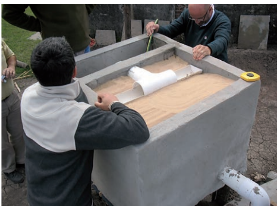
Figura 9. Filtro ya cargado con sistema vertedor en la superficie de la arena
